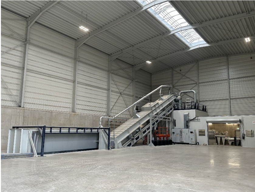
Anlage von REMEX in Hilden für die die Behandlung von KMF-Abfällen, © REMEX GmbH
